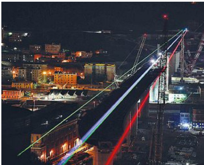
L'omaggio Un fascio di luce tricolore sul nuovo ponte in costruzione a Genova (Zennaro/Ansa)
